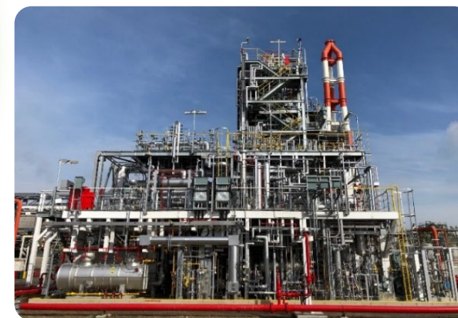
エタノール由来のエチレン試験製造設備
