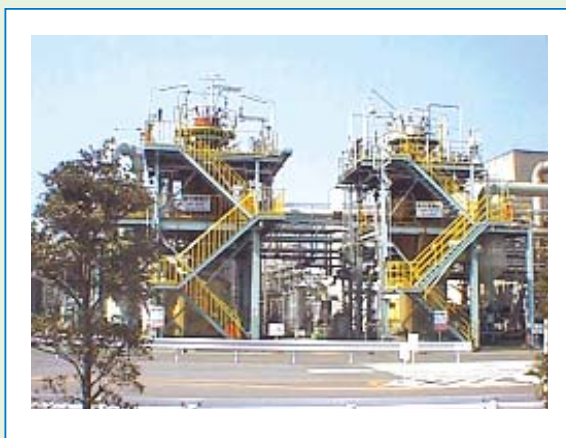
高濃度廃水焼却設備
