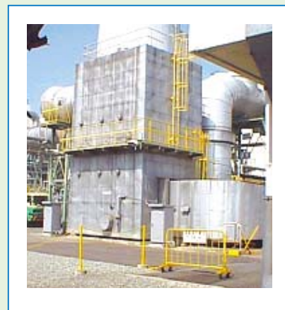
排煙脱硝設備
