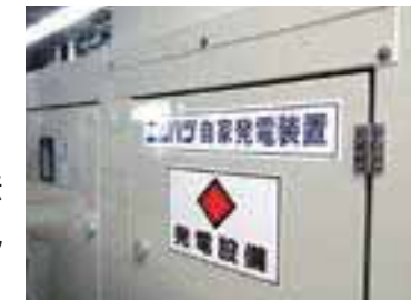
緊急用自家発電装置
